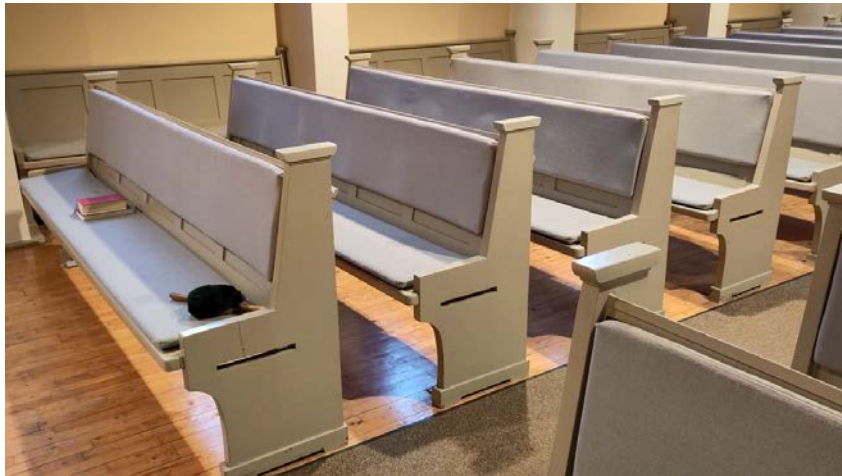
Abbildung 7-17: Im Jahr 2006 installierte elektrische Sitzbankheizung in der Kreuzkirche der Ev. Kirchengemeinde Olsberg-Bestwig. Optisch ist die Installation von einer Polsterung ohne Beheizung nicht zu unterscheiden. Die Kirchengemeinde ist auch nach 18 Jahren wartungsfreiem Betrieb von der Anlage überzeugt, nach Durchlaufen einer anfänglichen Lernkurve.
