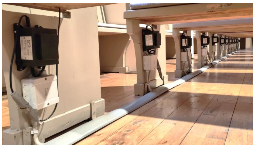
Abbildung 7-18: Unter jeder Bank ist die Installation der Transformatoren zu erkennen. Der Kanal der Verkabelung würde im Wiederholungsfall auf die Seite des Mittelganges verlegt, um das Reinigen des Bodens zu erleichtern.
