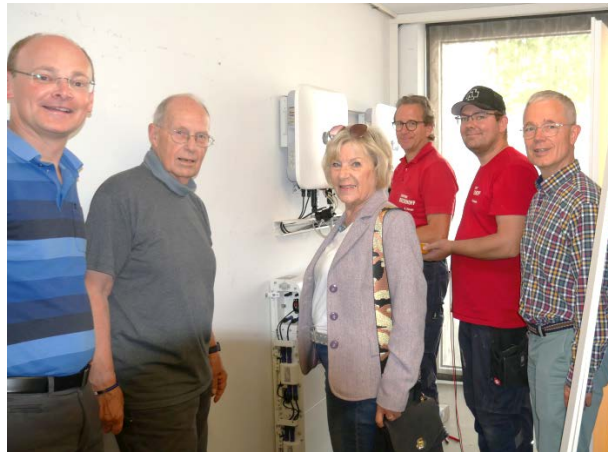
Abbildung 7-21: Umgesetzte PV-Anlage auf dem Flachdach des Gemeindehauses, sowie die handelnden Akteure (von links: Markus Kaulbars, Klimaschutzmanager Kirchenkreis Soest-Arnsberg, Architekten Sven und Gundl Busse, Kirchengemeinde Neheim, 2 Mitarbeiter der Fa. Beckhoff, Pfarrer Dr. Udo Arnoli, Kirchengemeinde Neheim)
