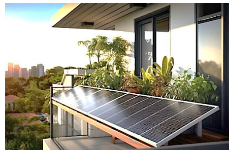
Abbildung 7-11: Balkonkraftwerk, Quelle: Franz Bachinger, Pixabay (C)
