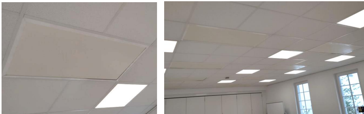
Abbildung 7-20: Infrarot-Deckenheizplatte im Gemeinderaum der Ev. Kirchengemeinde Olsberg-Bestwig. Links als einzelne Infrarotplatte, rechts im Verbund von 8 Reihen mit je 2 Elementen parallel. In der abgehängten Decke sind diese kaum zu erkennen.
