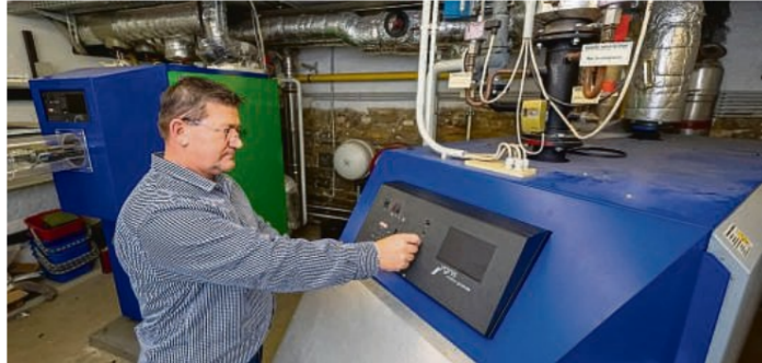
Hausmeister Elvir Puskarevic regelt die Heizungsanlage im Rathaus.
